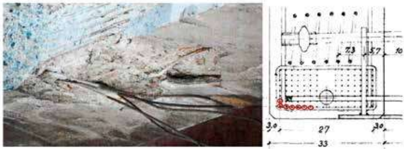
Figur 1: Påkørselsskade bro 14-0-073 OF sløjfen ved Kongens Lyngby
