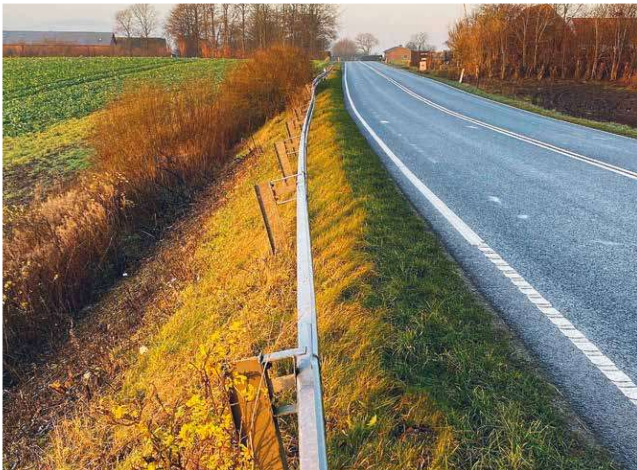
Billede fra den virkelige verden: Et ældre autoværn opsat i blød muldrabat nær kronekant. Det er tydeligt, at autoværnet skræner bagud og ikke yder den sikkerhed, det er tiltænkt.
