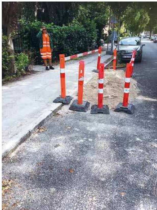
Her ses et eksempel fra Mariendalsvej, som er en klimavej med permeabel asfalt, hvor bærelaget fungerer som magasin. Ved en fortovsrenovering blev grus placeret direkte på den permeable asfalt, hvorfor permeabiliteten i vejen reduceres, og ved et skybrud vil vejen ikke kunne modtage den dimensionerede mængde regn. Det er desuden forbundet med ekstra driftsomkostninger, og det kan være svært helt at genskabe den oprindelige permeabilitet og kapacitet.
