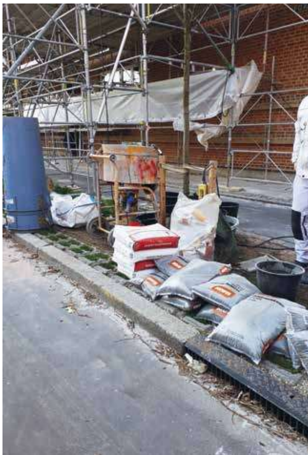
Her ses et eksempel fra P.G. Ramms Allé, som er en klimavej med et regnbed med underliggende magasiner. I bedet er lagt klimasten med græsarter, som kan skimtes under sækkene med grus. Vand ledes til bedet gennem Hugo risten i kantstenen. Ved et facadearbejde blev et stillads samt materialer og udstyr placeret i bedet. Disse aktiviteter kan potentielt have ødelagt dele af skybrudsløsningen, så den ikke kan rumme den dimensionerede mængde vand.
