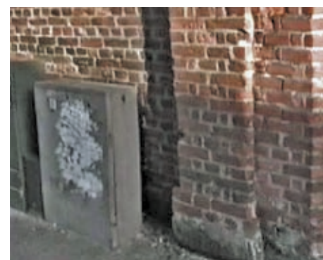
Eksempel på placering af installationsskabe før ombygningen. Foto ingeniørstuderende Per Thoft Kærsgaard.
